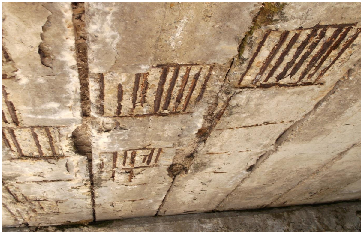
Poškodené železobetónové konštrukcie mostovky
