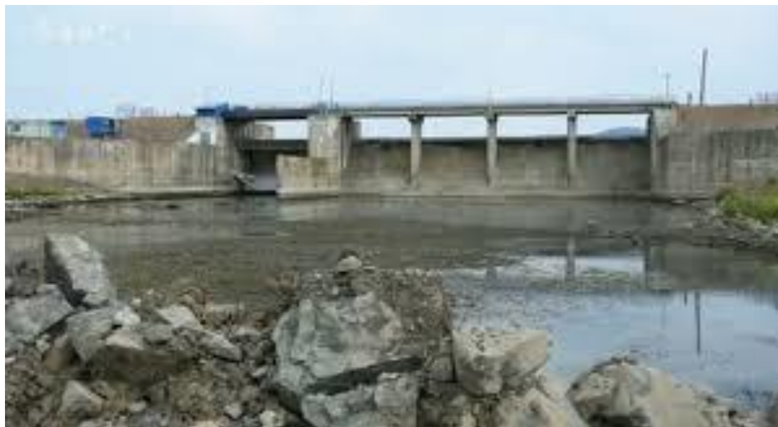
Bezpečnostný priepad pred rekonštrukciou
