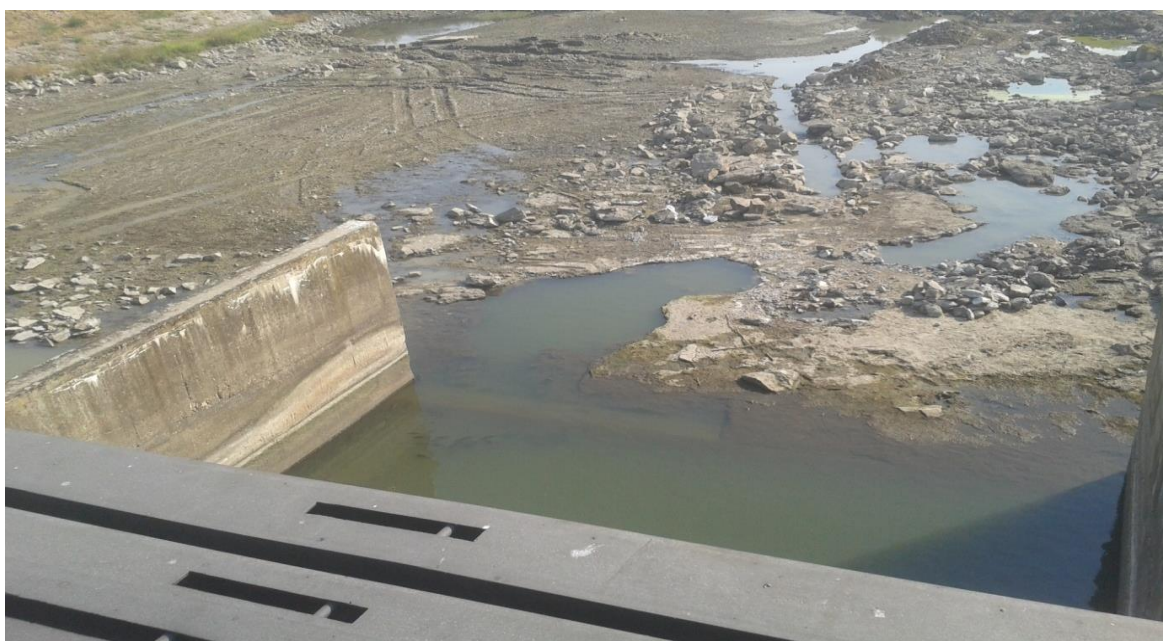
Poškodený vývar a kamenné opevnenie bezpečnostného priepadu
