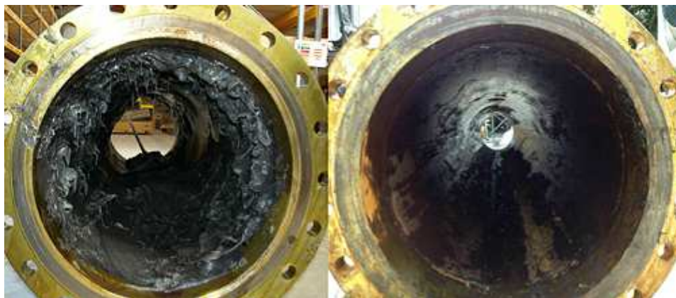
Obr. 5. Usadený parafín v stúpačkovej kolóne (vľavo), vpravo po aplikácii termickej metódy
