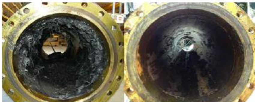
Obr. 5. Usadený parafín v stúpačkovej kolóne (vľavo), vpravo po aplikácii termickej metódy.
