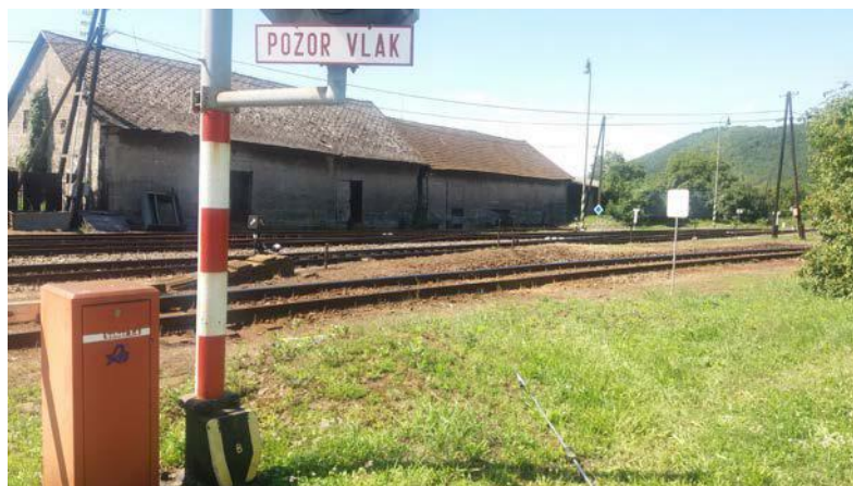
Obr. 2. Časť železnice, kde došlo ku havárii.
