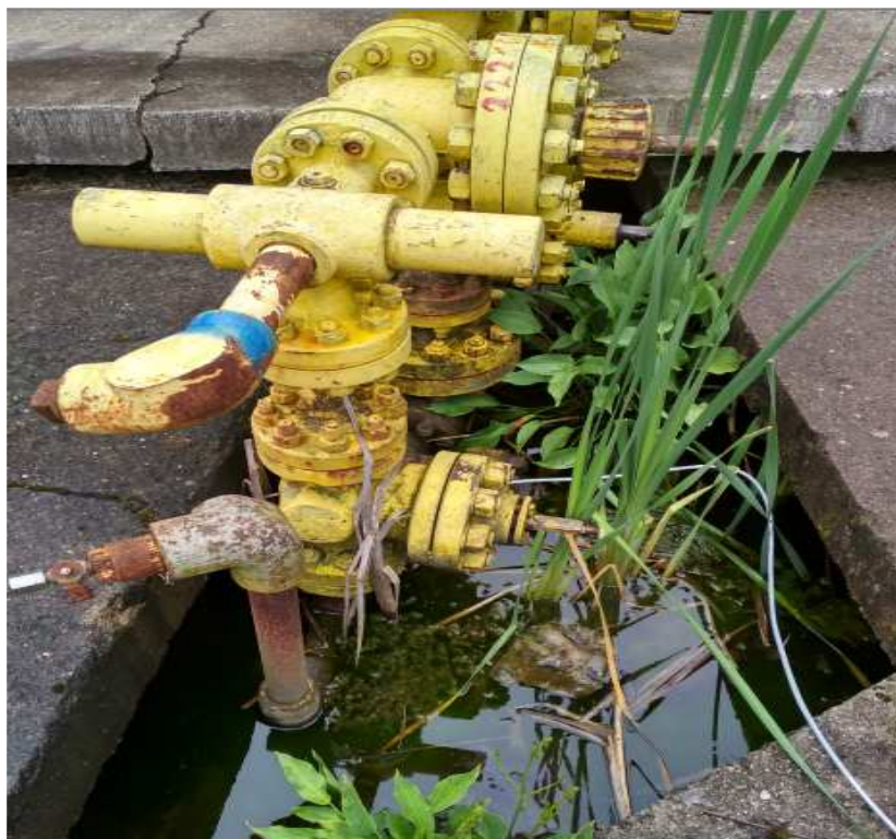
Obr. 2 Vystrojenie plynovej sondy s ústím sondy v kontakte s dažďovou vodou (s možným vznikom korózie) bez kamerového systému a bez oplatenia (foto archív autora)
